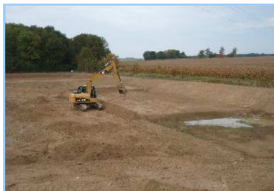
Opérations de terrassement (installation de diguettes) lors de la conception de la ZTHA de Rampillon. Photo : Irstea
